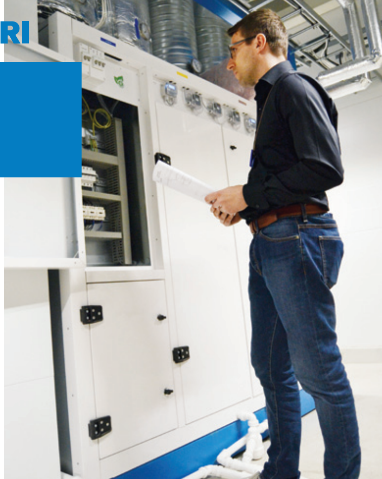
Pieksämäen Lidlin talotekniikkakeskus edustaa Modulsin uusinta teknologiaa.
