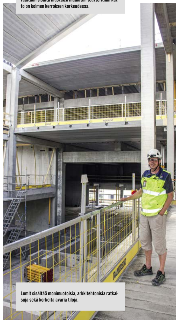
Black Boxin seinissä on Lipa-Betonin elementit. Kattaaltaan sisältä mustaksi maalattu teatteritilan katto on kolmen kerroksen korkeudessa.
